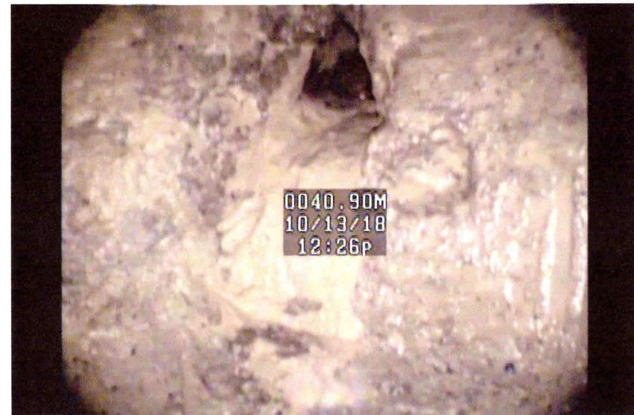
Imagen Horizontal de Grieta
